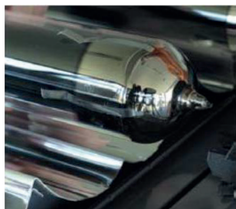
газопоглинач у порядку, трубка справна
